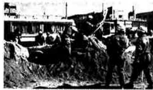
崩れた土砂の中から乗用車を掘り起こす。連携が図られる瞬間
